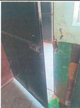
Foto 7: Daños en pintura de muro interior
