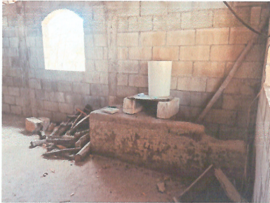
Foto 5: Daños en área de cocina
