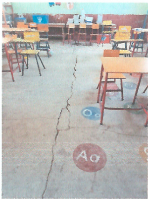
Foto 1: Daños en los pisos de las aulas
