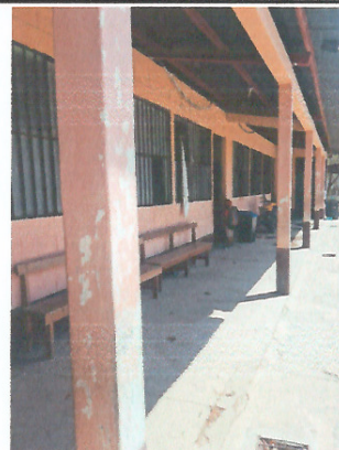
Foto 2: Daños en la pintura exterior e interior
