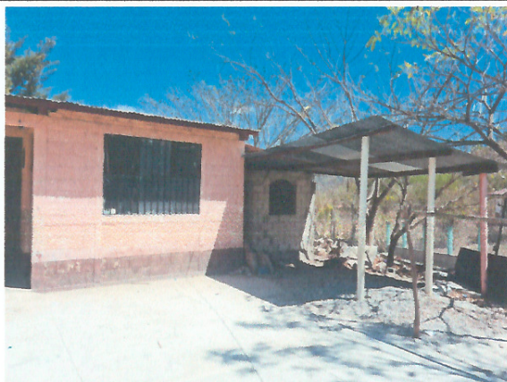
Foto 3: Daños en el área de cocina
