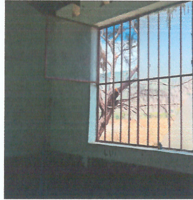
Foto 6: Daños en la pintura exterior e interior
