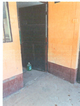
Foto 8: Daños en piso, pintura y puertas
